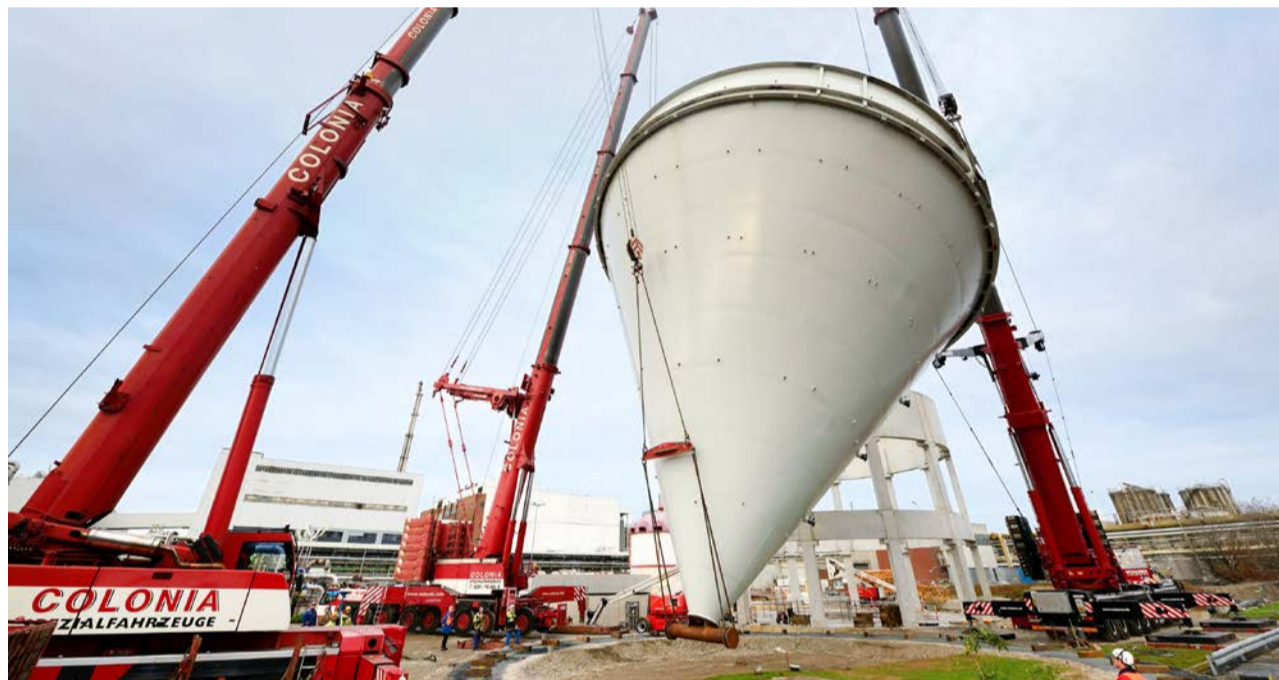
Am Haken: Drei 500-Tonnen-Kräne drehen das trichterförmige Brunnengefäß zunächst und setzen es dann in eine Tragekonstruktion.
